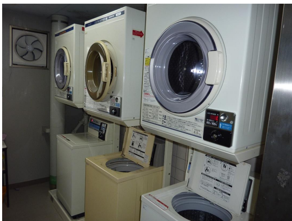
ランドリー室
